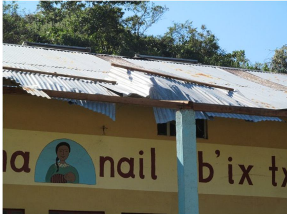
Het beschadigde dak van de clínica.
